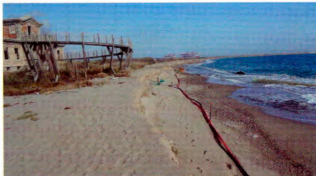
Figura 2. Erosió de la platja enfront de l'antic quarter dels Carrabiners, al delta del Llobregat, després d'un temporal. S'observa un cablejat i una canonada de presa d'aigua per la planta dessaladora del delta, que van quedar al descobert. Novembre 2014.
